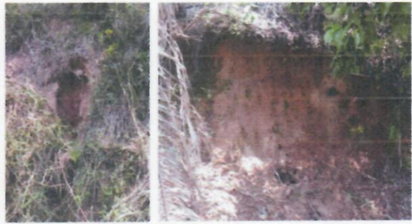
Inicio de procesos de erosión por acción antrópica (Excavaciones por caza de lombrices y oro).
