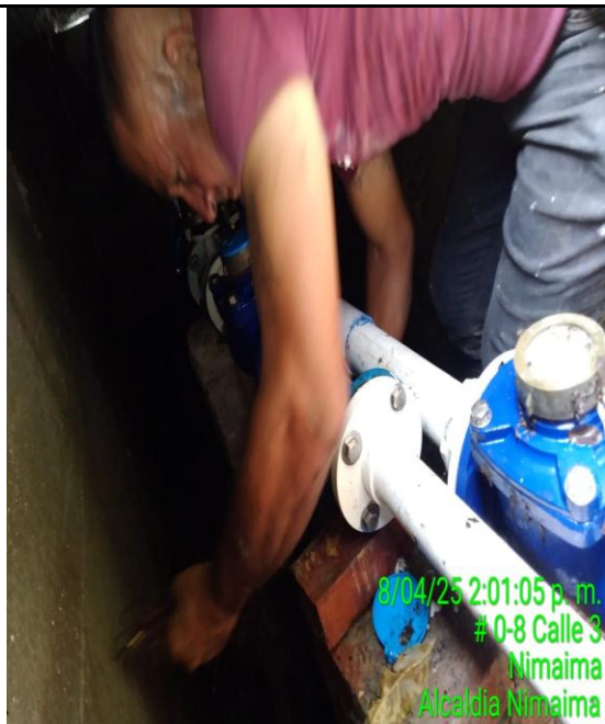
Ilustración 5: Instalación de macro medidores en la salida y entrada de la planta de tratamiento de agua potable.
