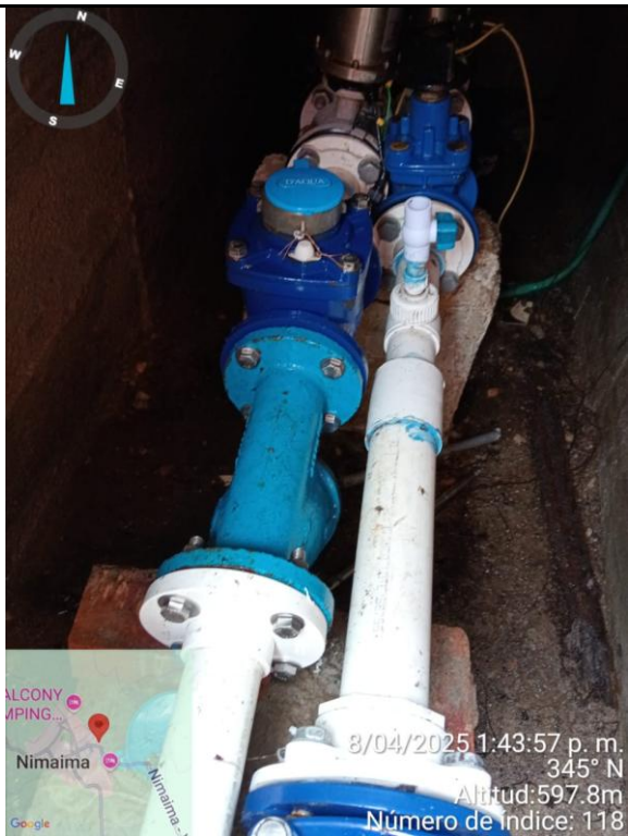
Ilustración 6: Macro medidores instalados.
