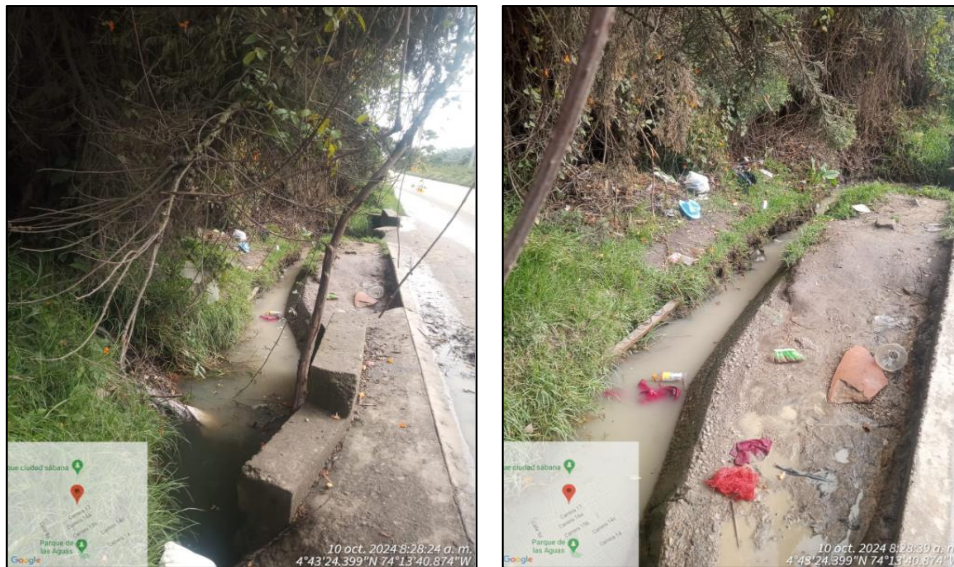
Ilustración 1. Estado inmediaciones de la zona próxima al canal.
