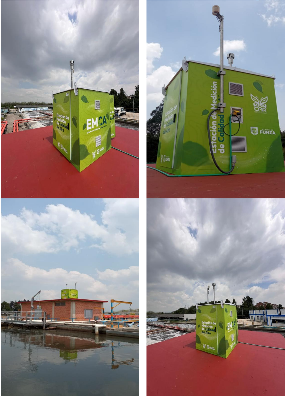
Ilustración 14. Cabina instalada con equipos y accesorios en PTAR de Funza.
