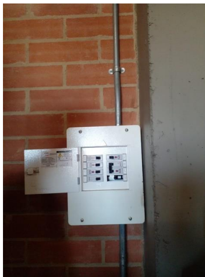
Ilustración 4. Revisión de la caja de breackers para la toma de energía eléctrica.
