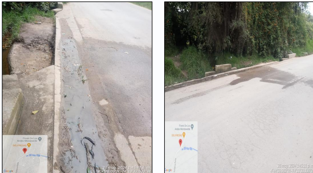
Ilustración No. 1. Marca de agua al costado de la vía
