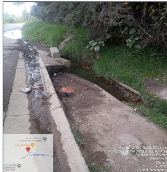
Ilustración No. 5. Estado del canal al término del operativo
