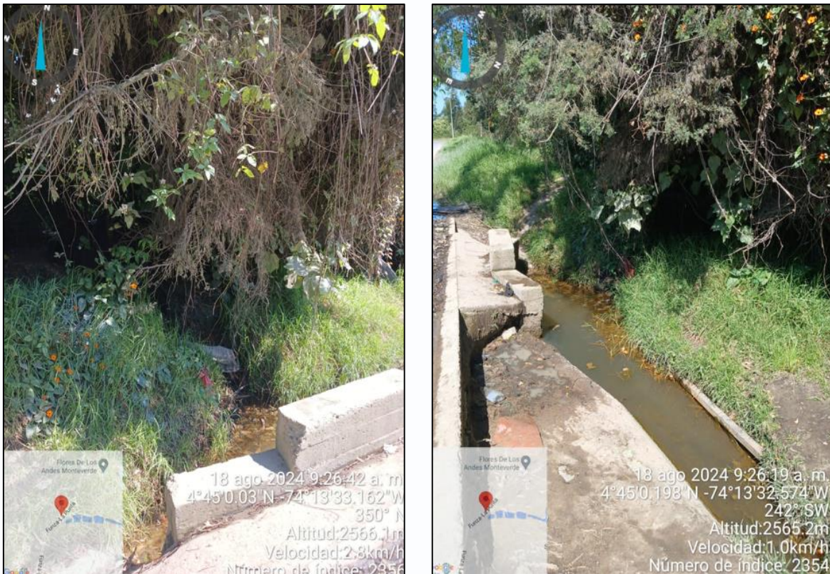
Ilustración No.4 Estado del canal al término del operativo
