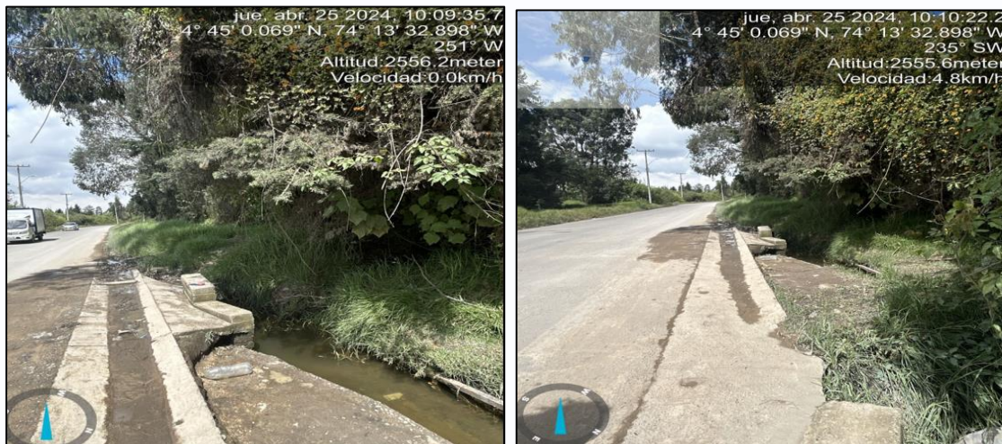
Ilustración No. 1. Marca de agua al costado de la vía- canal
