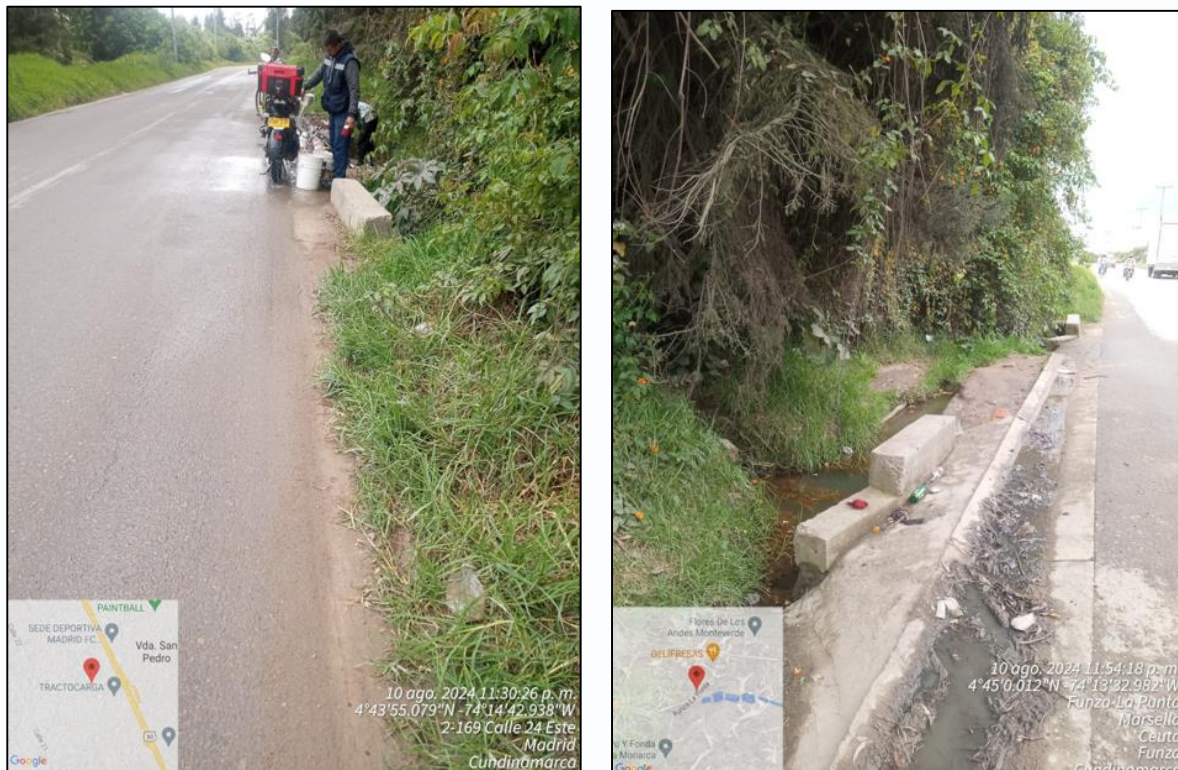
Ilustración No. 1. Estado inmediaciones de la zona proximal al canal
