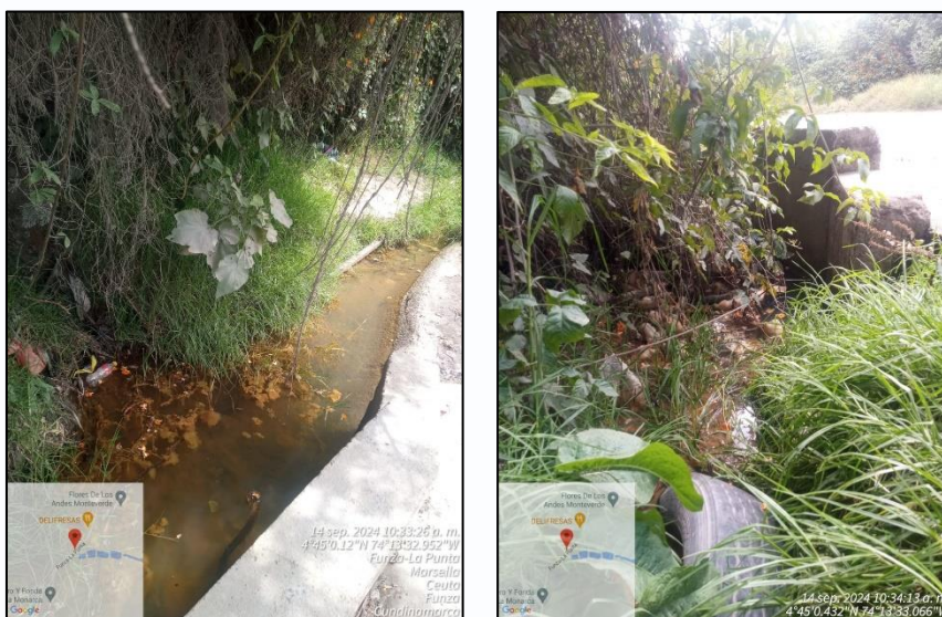
Ilustración No.1. Estado inmediaciones de la zona próxima al canal
