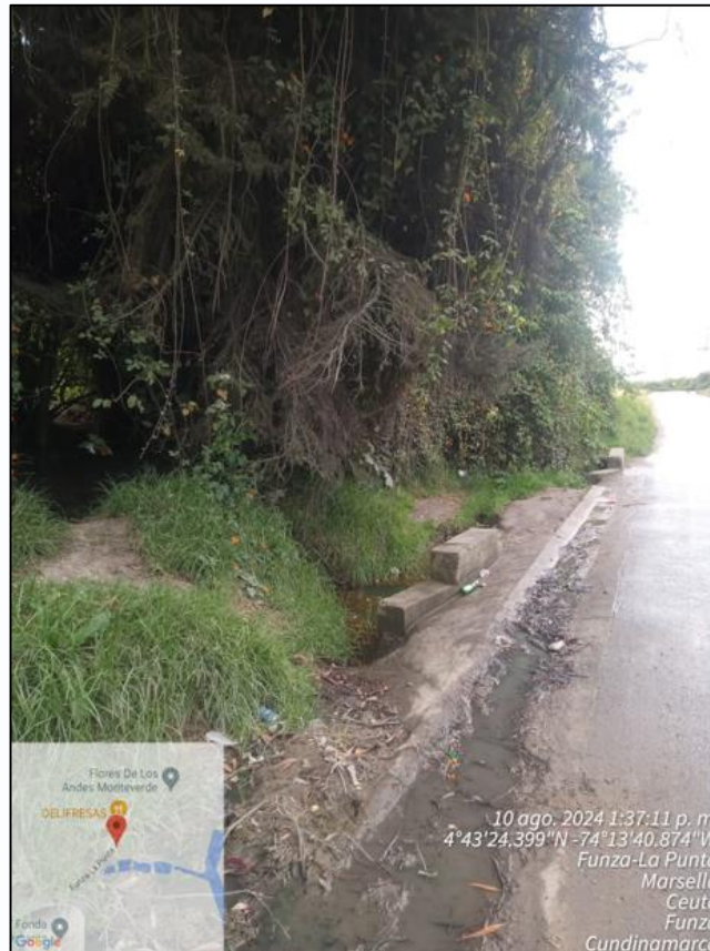
Ilustración 4. Estado del canal al término del operativo
