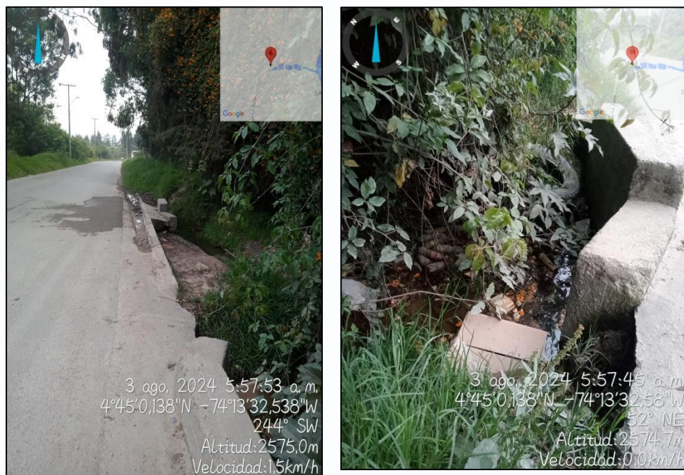
Ilustración No.1. Estado inmediaciones de la zona próxima al canal
