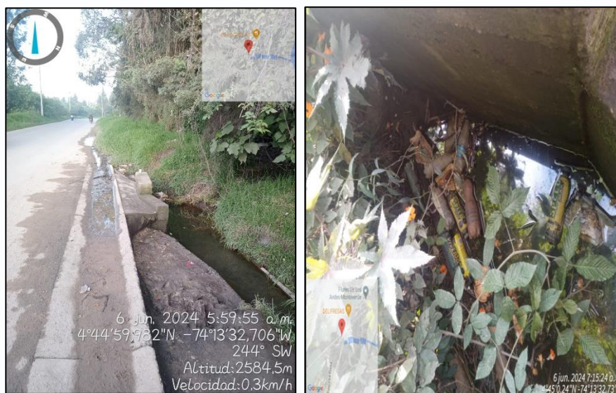
Ilustración No.1. Estado inmediaciones de la zona próxima al canal
