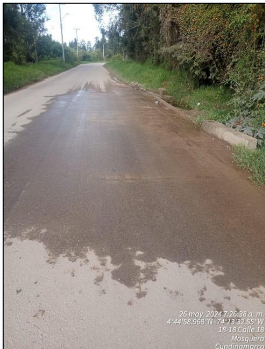
Ilustración No. 1. Marca de agua al costado del canal
