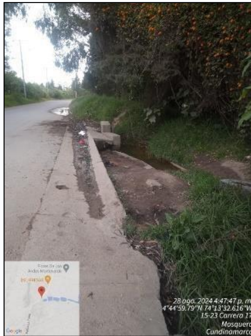
Ilustración 4. Estado del canal al término del operativo
