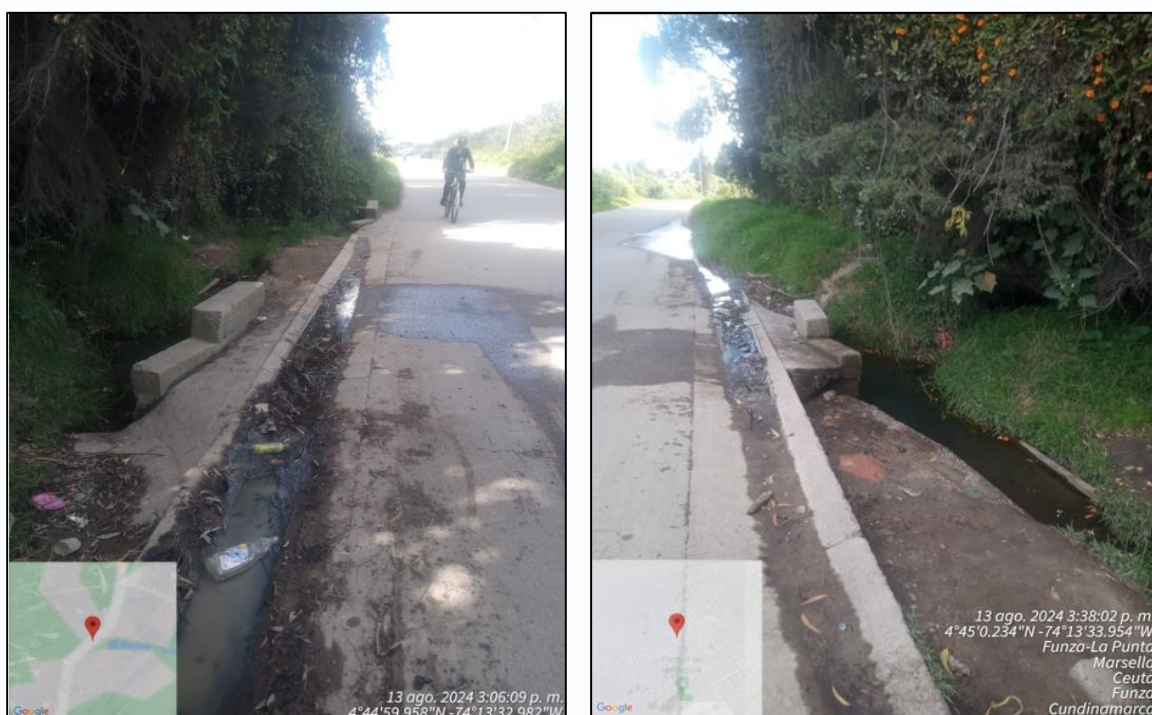
Ilustración No. 1. Estado de inmediaciones de la zona próxima al canal.
