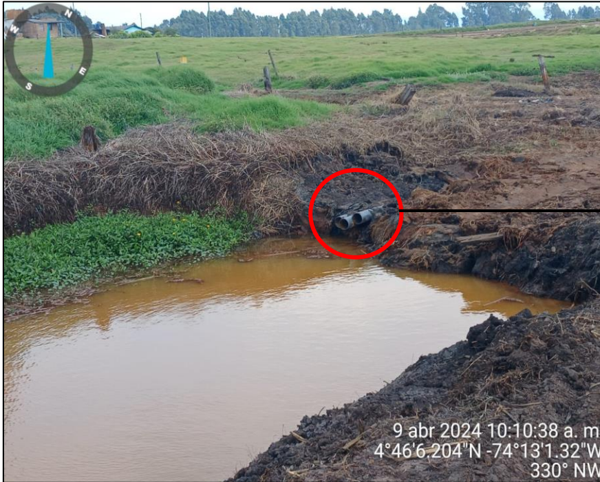
Ilustración 4. Tuberías en cuerpo de agua del humedal
