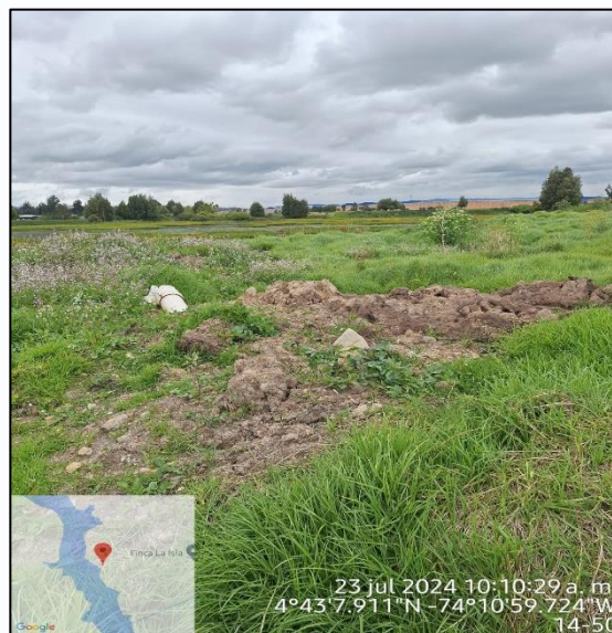
Ilustración 3. Acumulación material de excavación.
