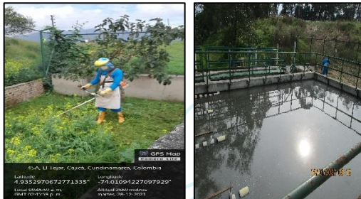
Fotografía 10. Actividades de operación y mantenimiento PTAR Rincón Santo
