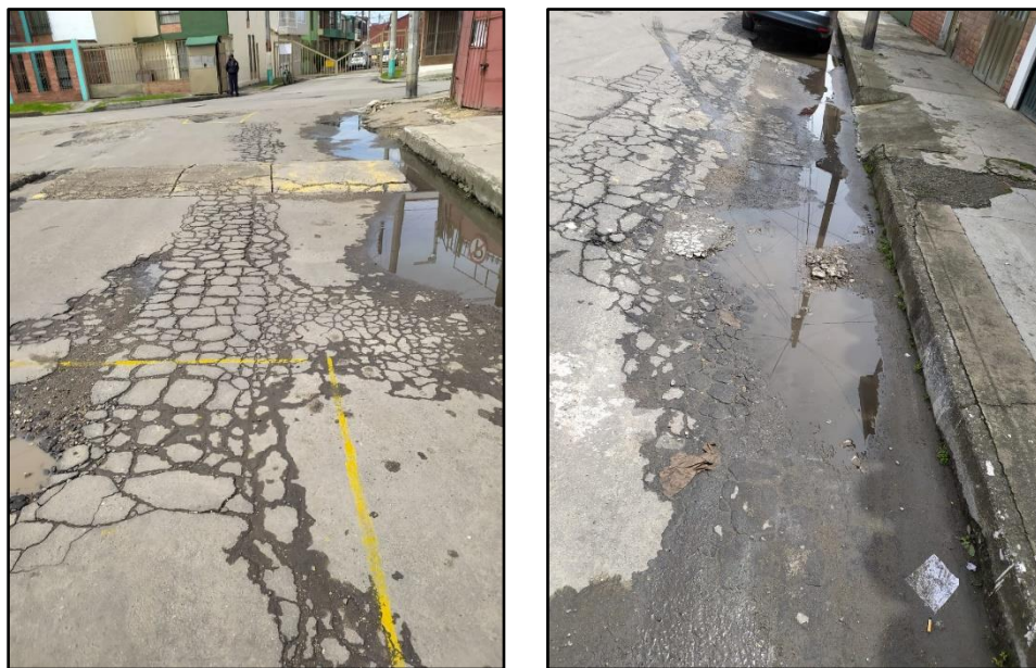
Figura 40. Patología sobre pavimento por hundimiento de la sub-base
