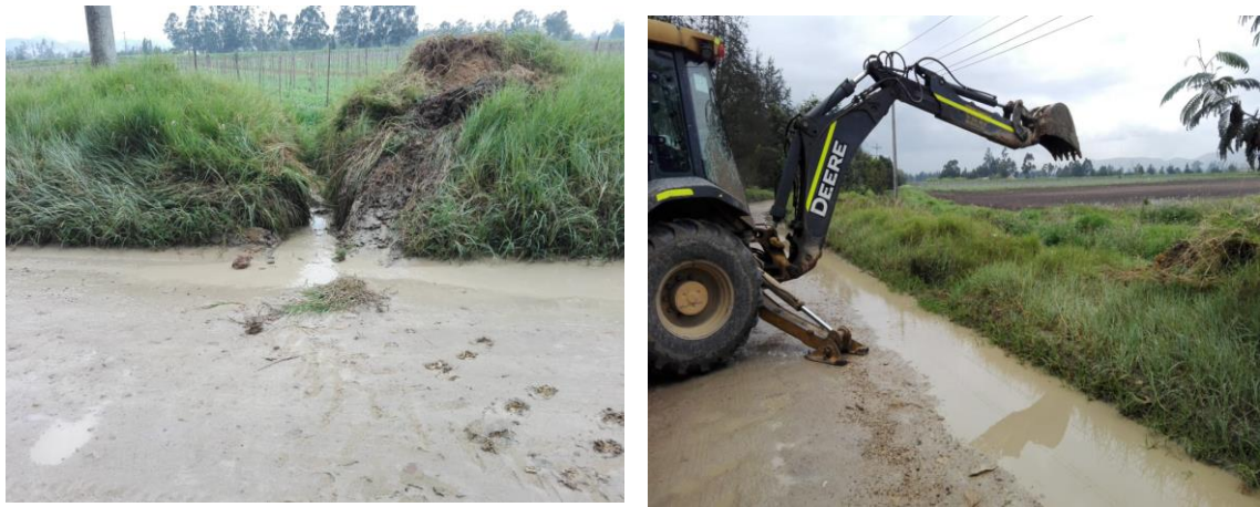
Figura 42. Inundaciones y desbordamiento de canales de riego.
