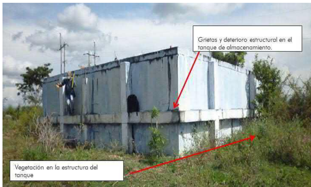
Ilustración 48. Tanque de almacenamiento del acueducto de Puerto Libre
