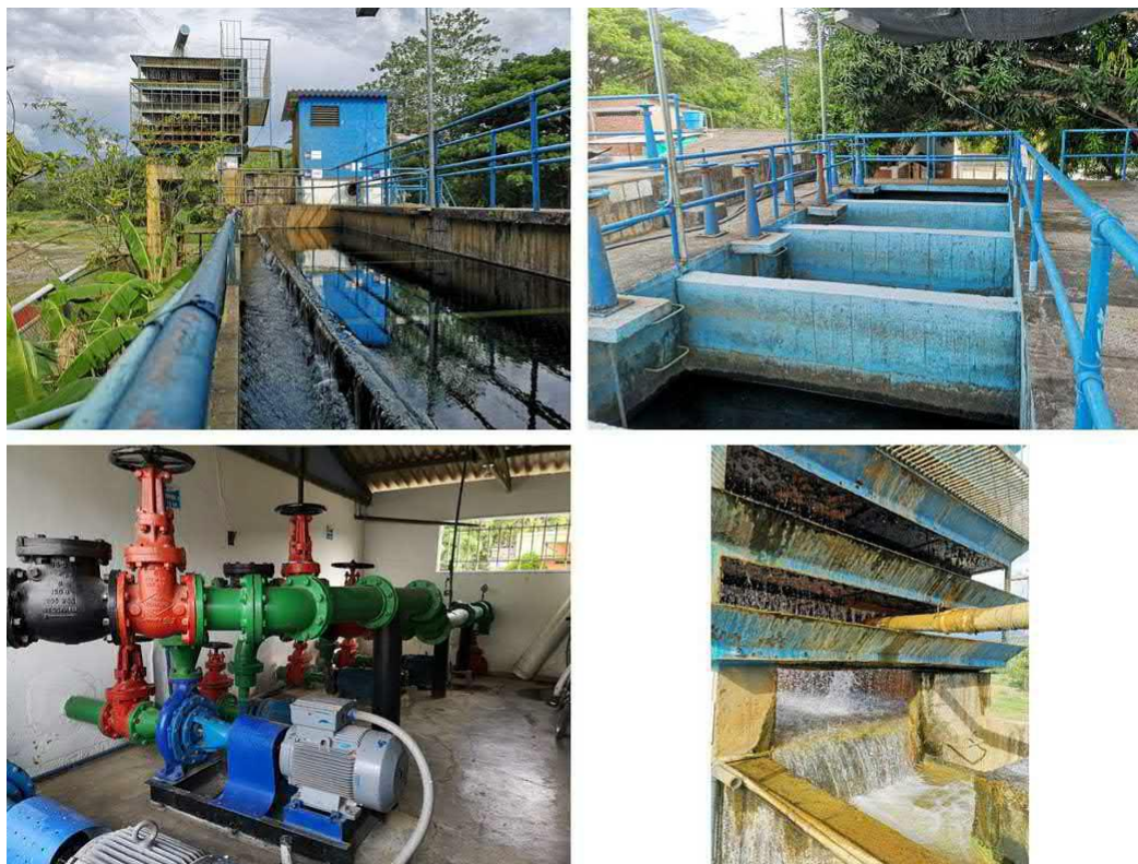
Ilustración 46. Planta de tratamiento de agua potable
