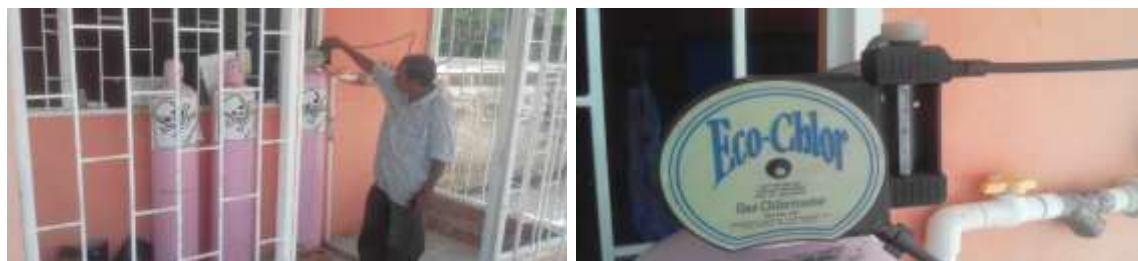
Fotos N° 8 Y 9 Planta de tratamiento Fuente: Grupo de trabajo de LA oficina de servicios públicos
