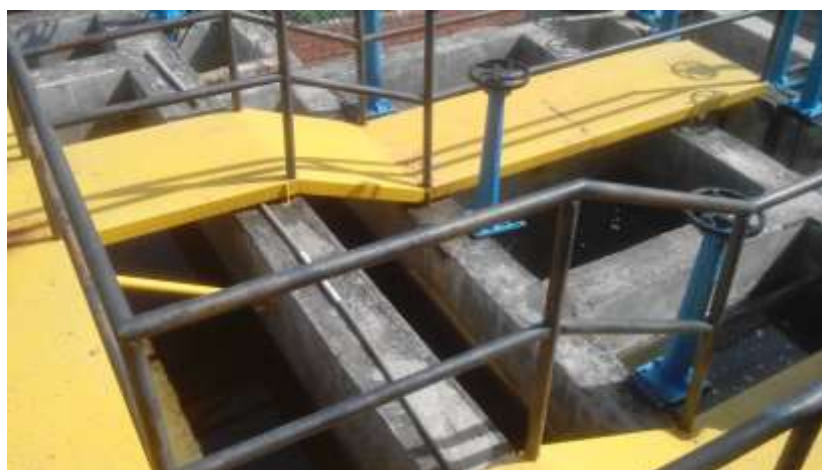
Foto N° 7 Plata de tratamiento Foto tomada el 15 de Abril 2015, funcionamiento de la PTAP municipal. Fuente: Grupo de trabajo
