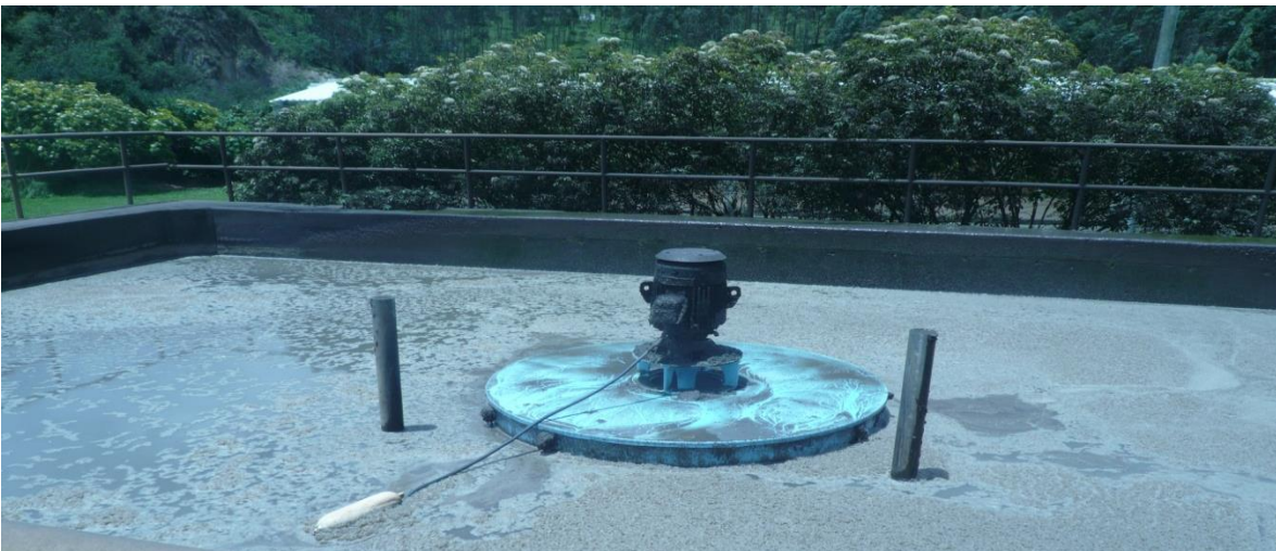
Figura 19. Digestor de lodos
