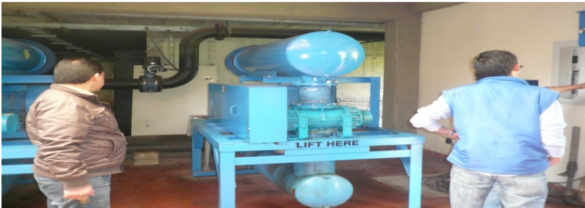
Figura 22. Tuberías de conexión
