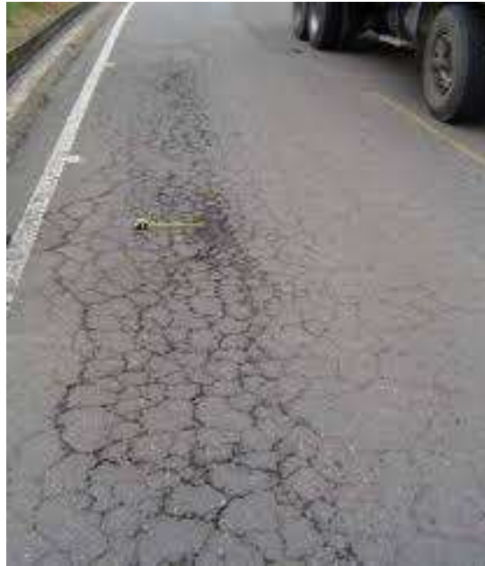
Ilustración 35. Daño por falla en carreteras
