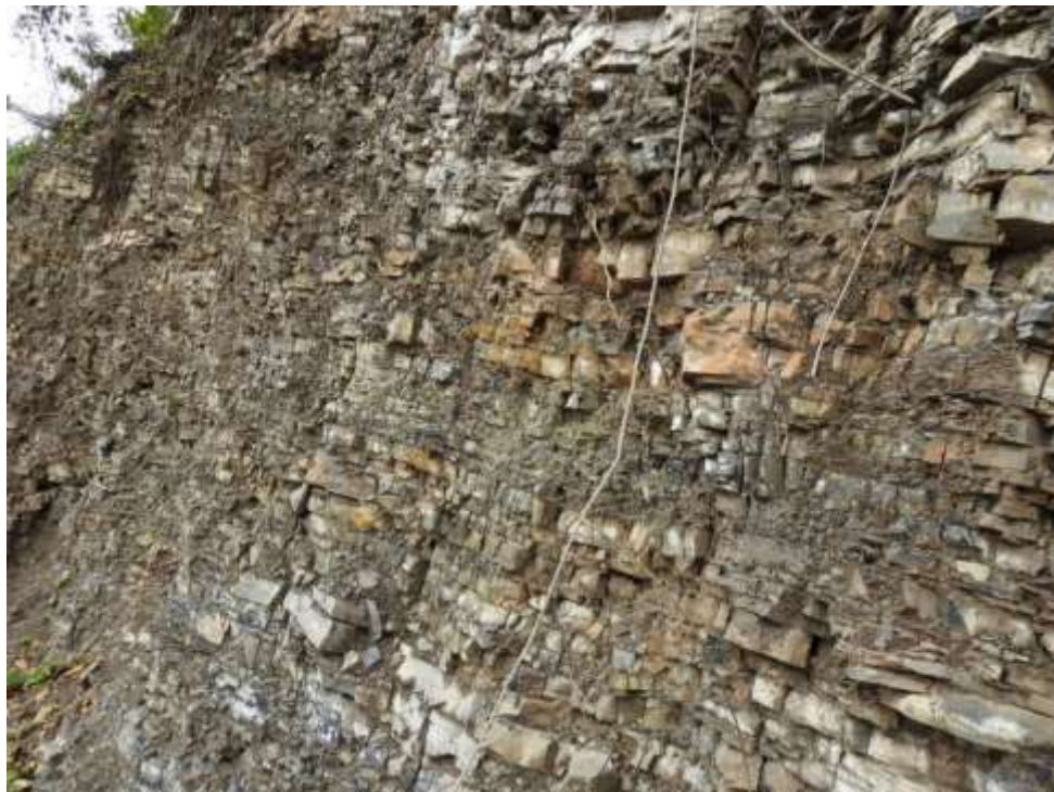
Ilustración 24. Escarpes y perdida de estabilidad y deslizamientos
