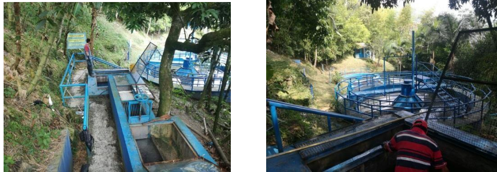
Ilustración 31. Planta de Tratamiento de agua residual
