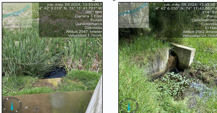
Ilustración 49. Descarga de aguas lluvias a cuerpos hídricos
