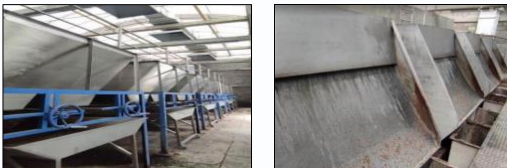
Ilustración 14. Sistema de cribado
